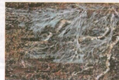
Домовый гриб (поражает деревянные строения)
